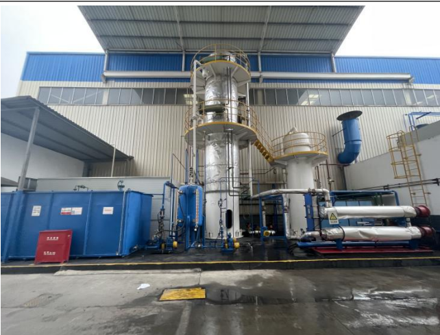
废气处理设施
