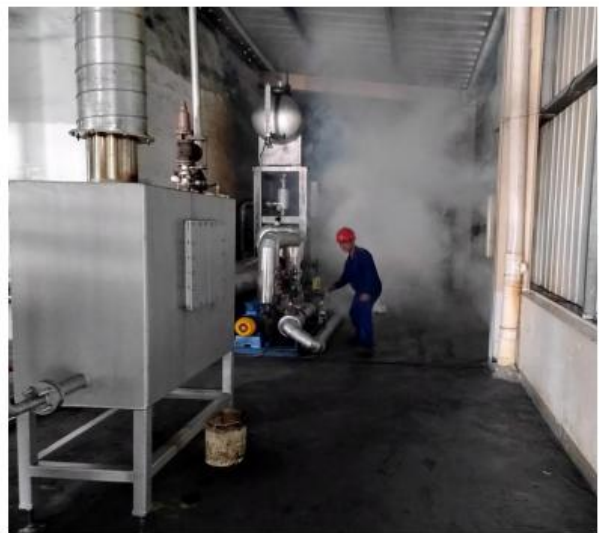
炼油房操作人员陈一夫发现炼油房内部高温导热油发生泄漏导致冒烟自燃
